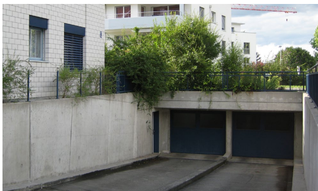
Abb. 2: Ungünstige Lösung mit der Ein- und Ausfahrt direkt vor dem Wohnzimmerfenster und mit Sicht auf die schallharten Rampenwände. Bild: FALS
